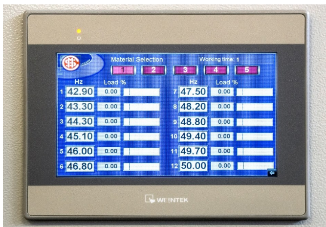
Figura 2: pannello di controllo del laminatoio con inverter
